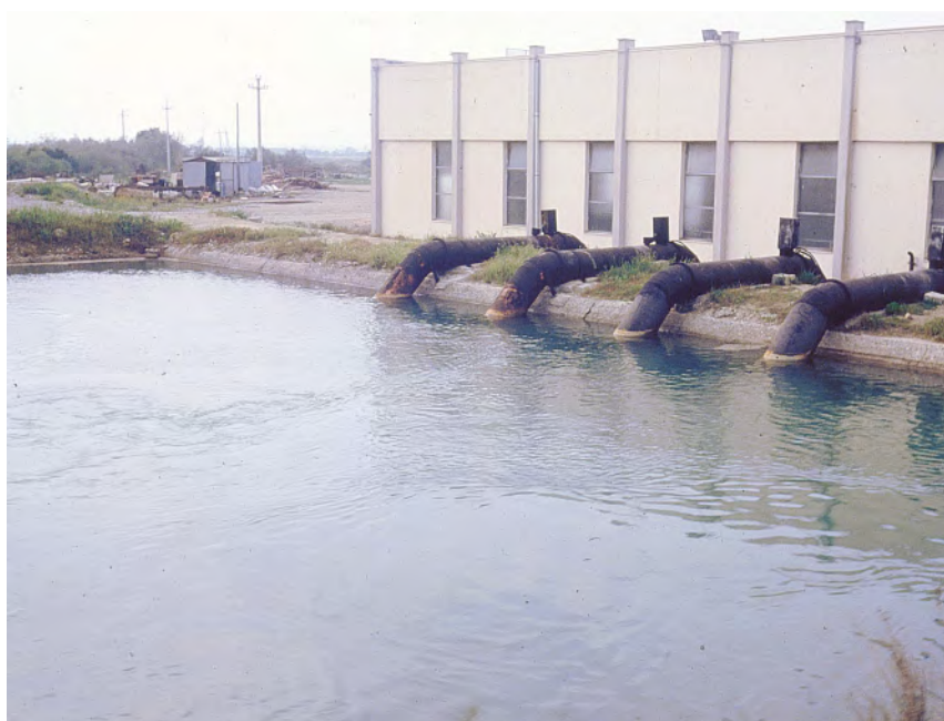
Stazione di pompaggio. Foto di M. Rampacci.
