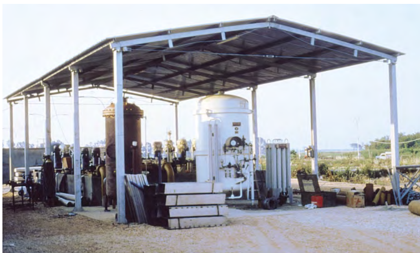
Sistema di stoccaggio di ossigeno liquido. Foto di M. Rampacci.
