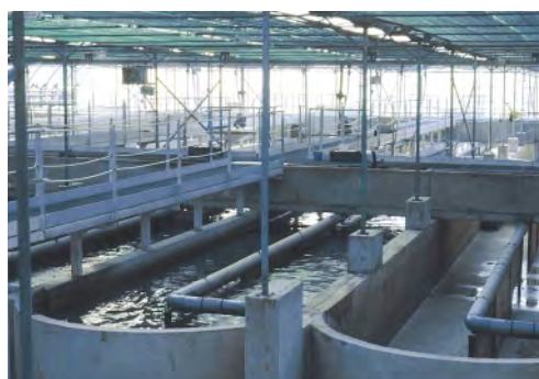
Impianto moderno con vasche in PVC. Foto di M. Rampacci.
