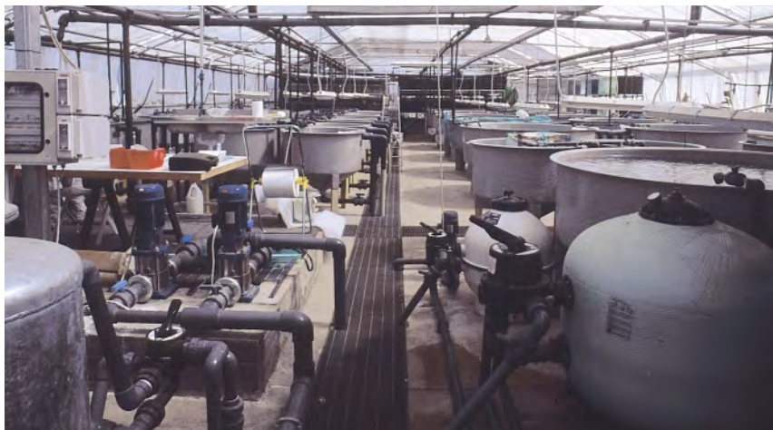
Panoramica interna della serra di produzione. Foto d'archivio Panaque.
