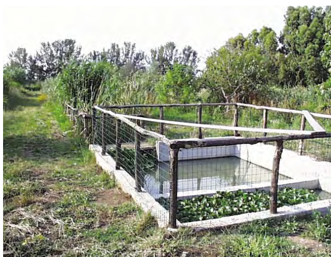
Vasca di sedimentazione e canale di fitodepurazione per il trattamento fisico, chimico e biologico dei reflui di un impianto di piscicoltura "a ricircolo". L.E.S.A. Università di Roma "Tor Vergata". Foto di L. Tancioni.
