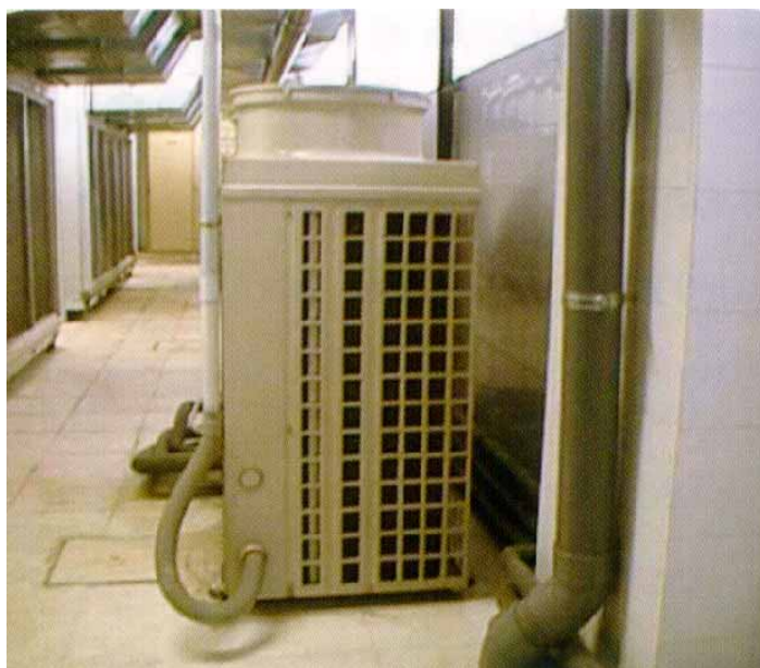
Foto 4. Condensador de un grupo de frío.
