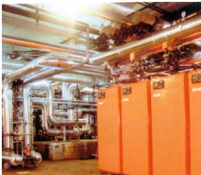
Foto 5. Calderas para agua caliente.
