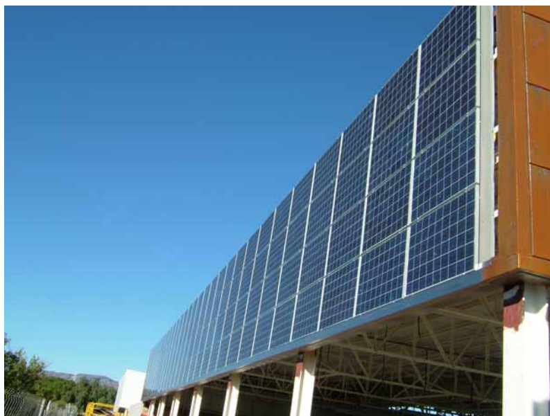
Foto 2. Fachada fotovoltaica. Piscina municipal.
